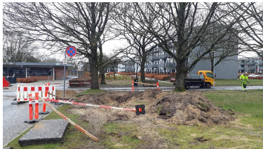
Træ på HP Hansensvej som er blevet beskadiget ved gravearbejde. Foto: Anne Kirstine Kjær
